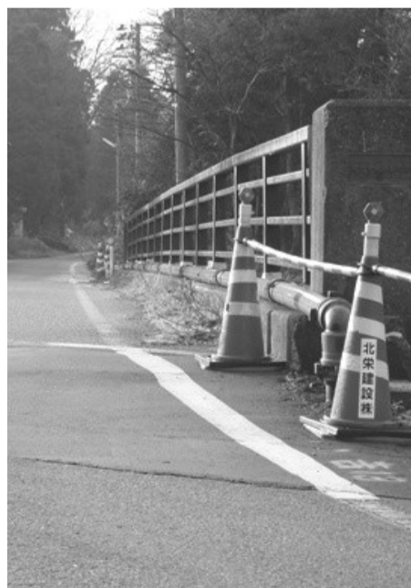
早急に段差解消をの聲がでている新保橋付近。
