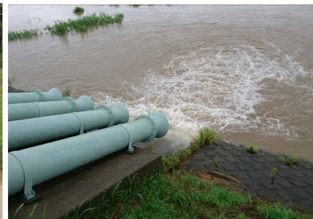
水戸の川排水機場付近(7/1 16:40)
